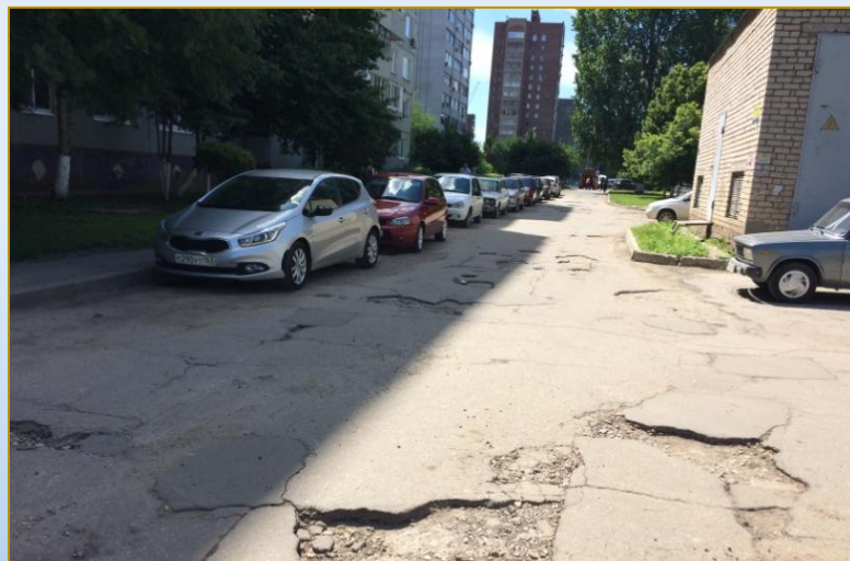
Фото объекта «До»
