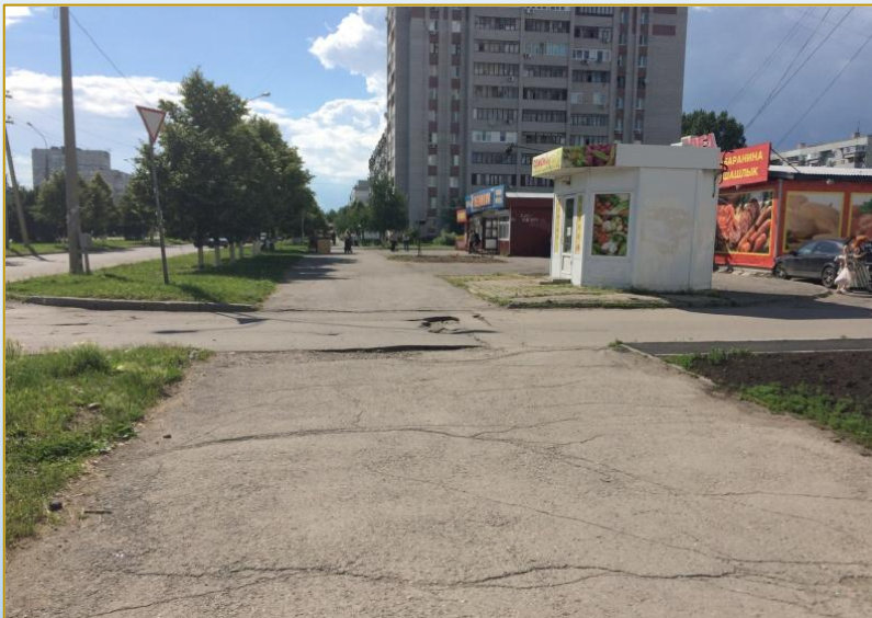
Фото объекта «До»
