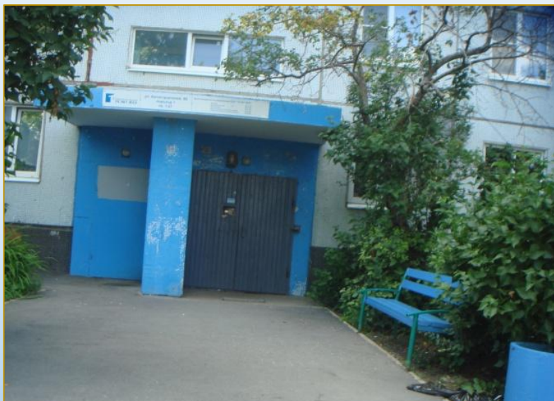
Фото объекта «До»
