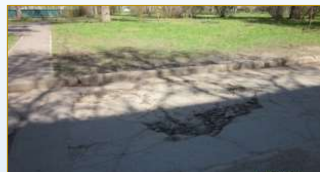
Фото объекта «До»
