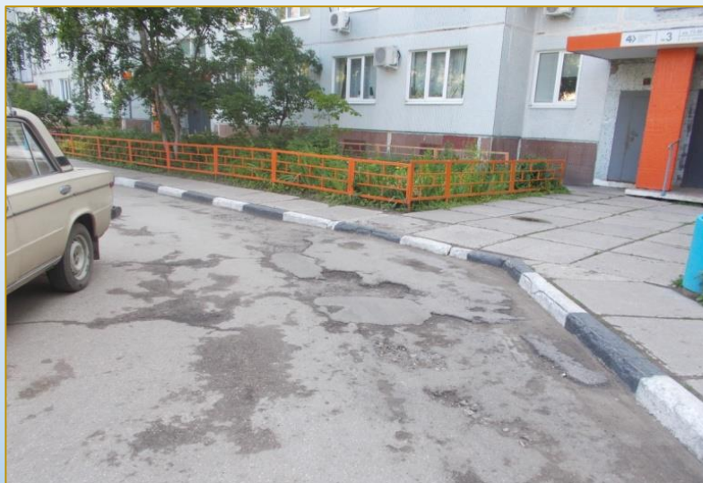
Фото объекта «До»
