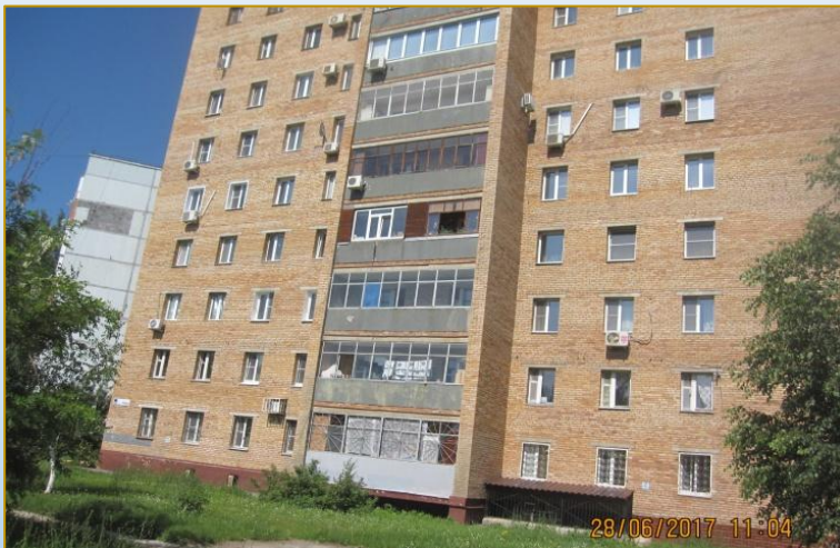
Фото объекта «До»
