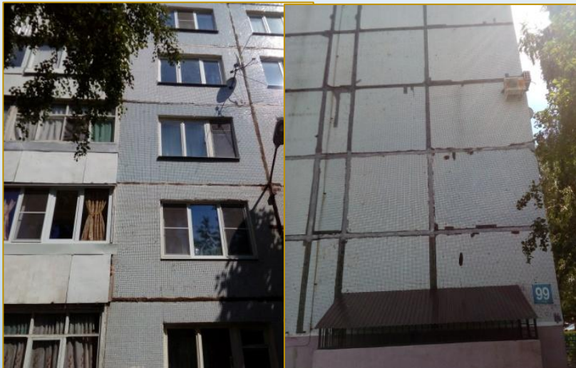
Фото объекта «До»
