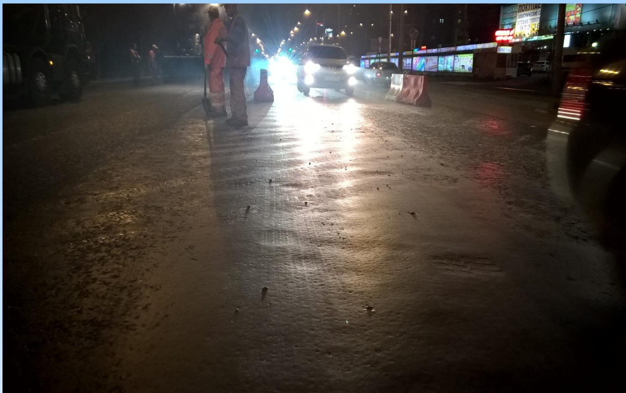
Участок автомобильной дороги с избытком битума
