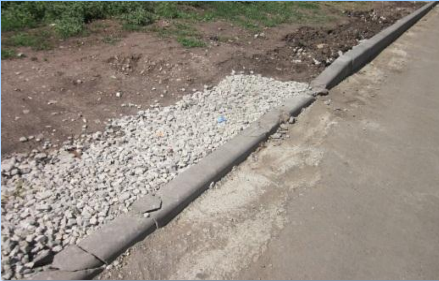
Разрушение бортового камня
