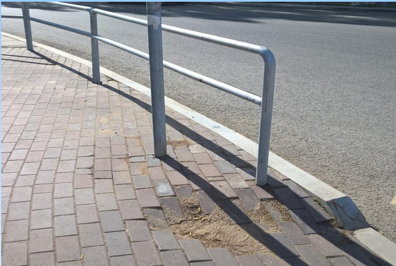
Просадка плитки вследствие некачественно подготовленного основания
