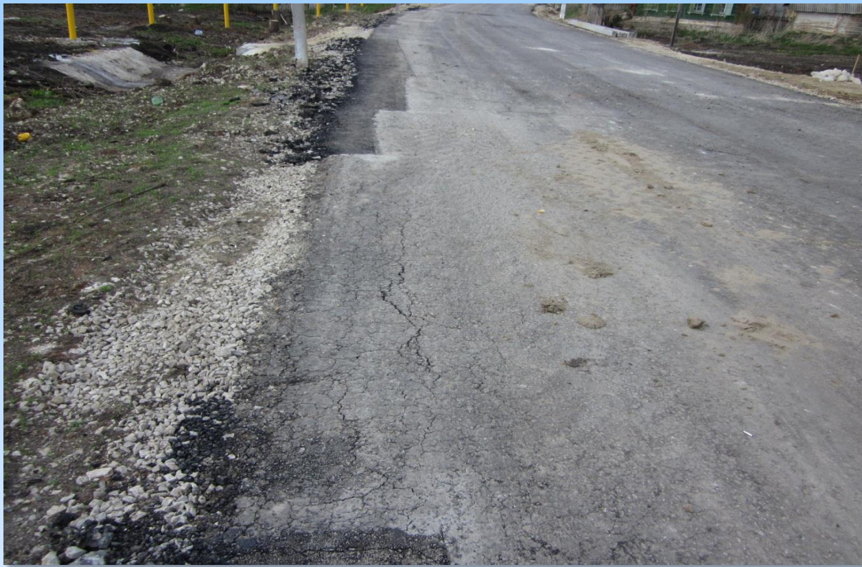
Разрушение кромки асфальтобетонного покрытия
