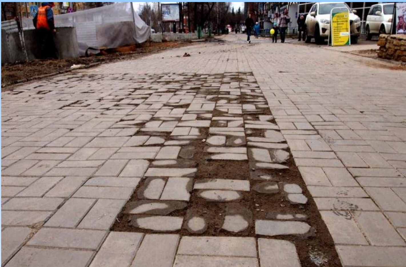
Дефектная партия плитки вследствие нарушения технологии её изготовления заводом-производителем
