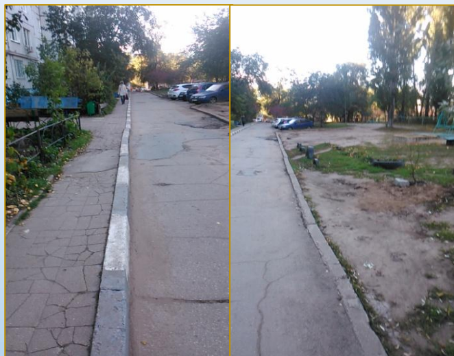
Фото объекта «До»
