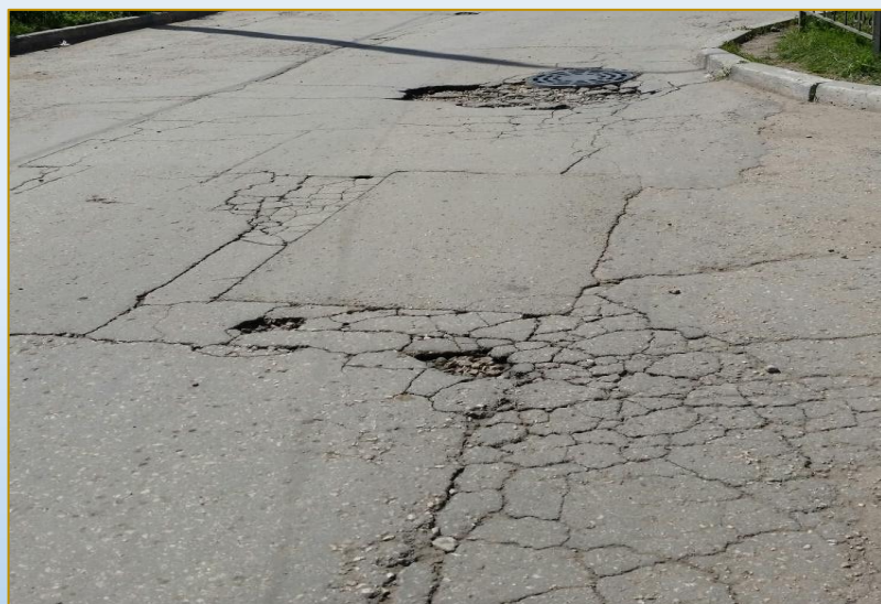
Фото объекта «До»
