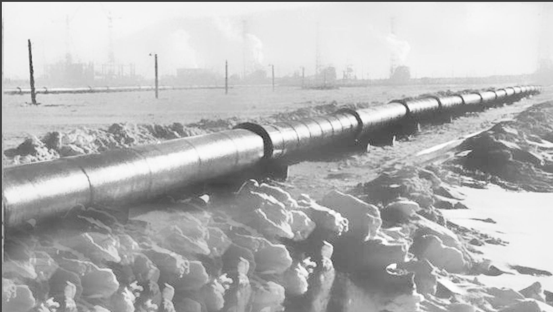
Пульпопровод в Правобережном строительном районе
